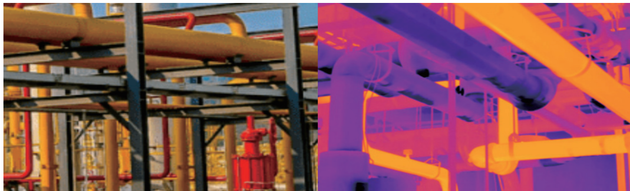
蒸汽管道泄漏监测
