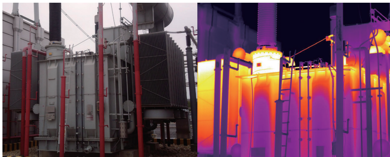
变电设备检测
