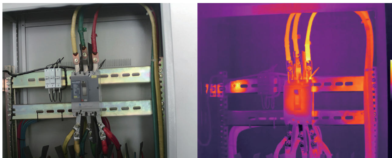
电气设备接点检测
